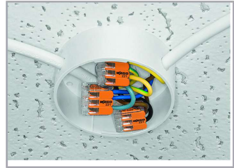
Verdeling van verlichtingssystemen in centraaldozen
